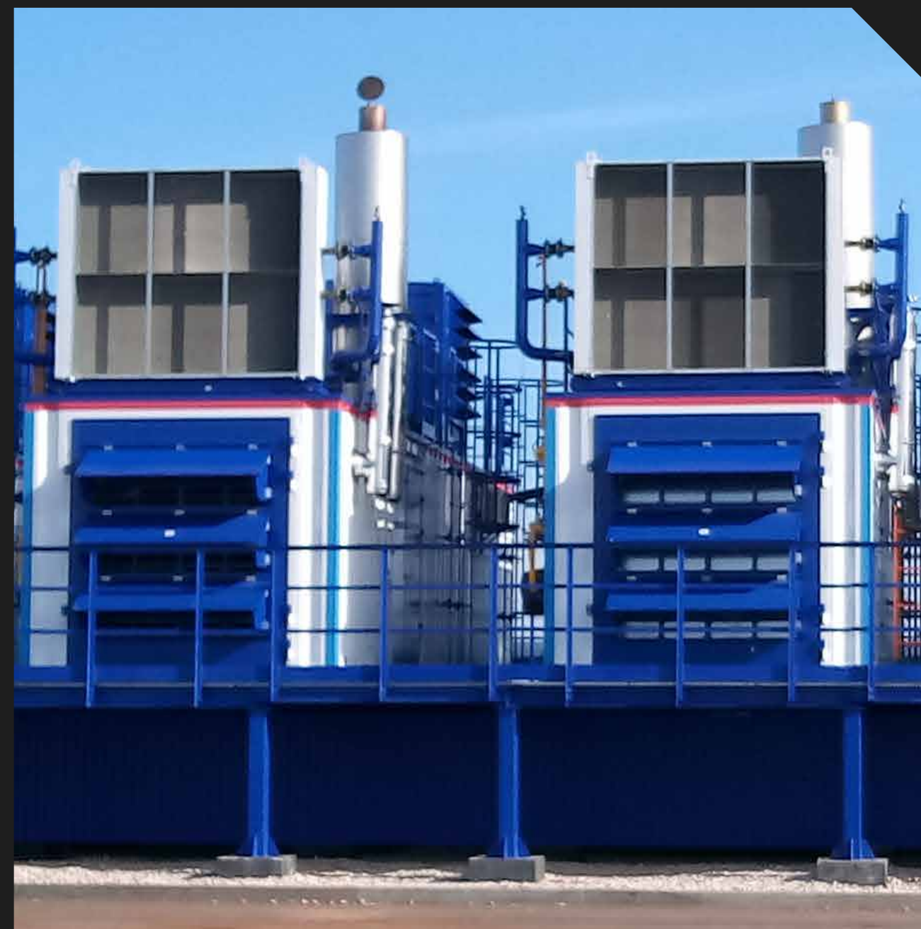
Два энергокомплекса по 4 МВт для КСПГ «НОВАТЭК»
