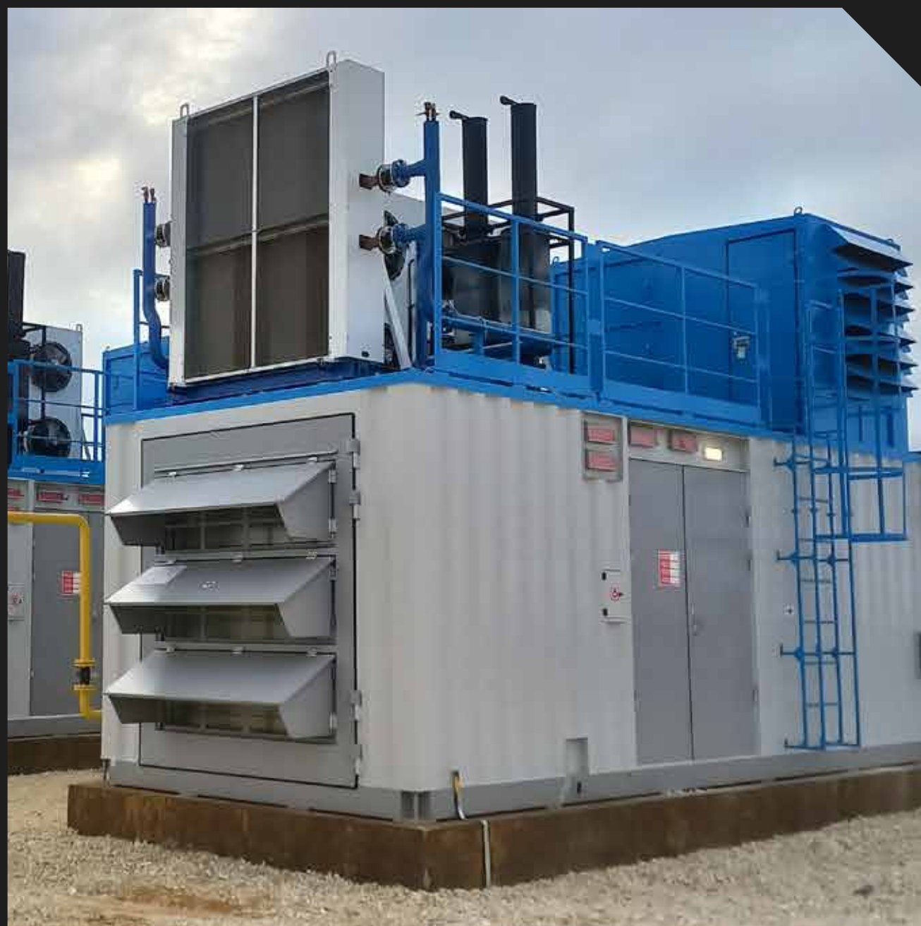
Энергокомплексы 1,4 и 2,1 МВт для КСПГ «Газпром»
