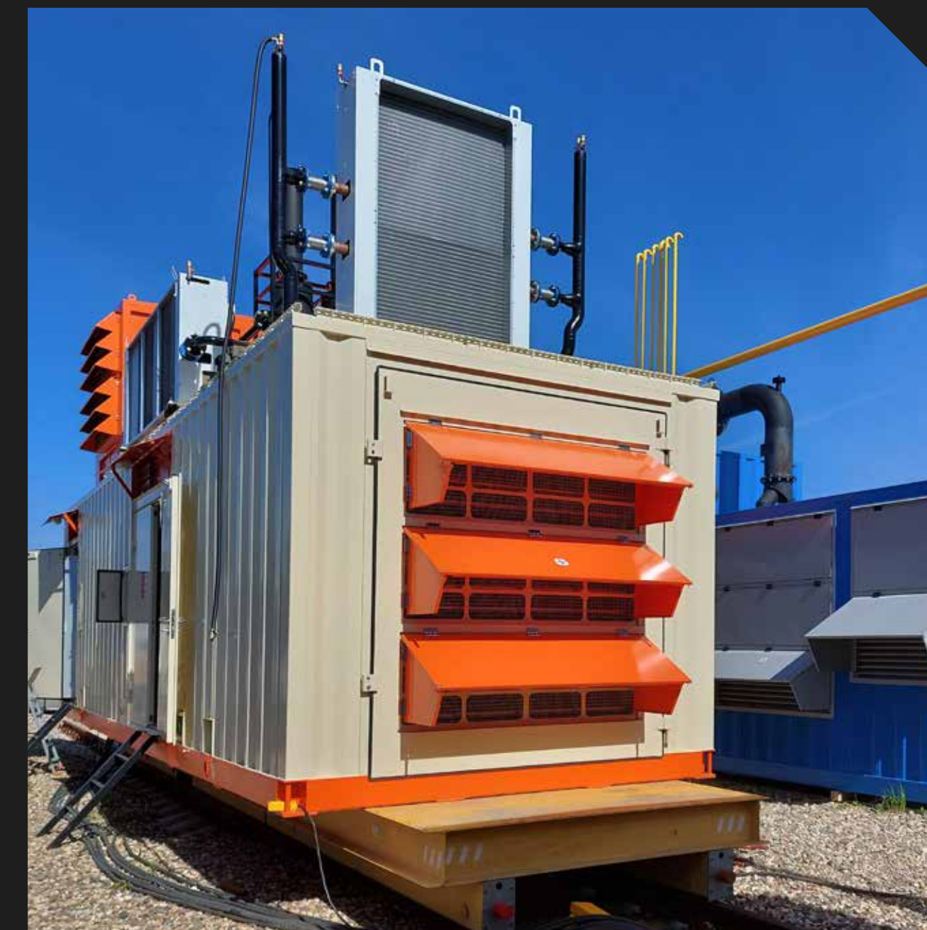
Энергокомплекс 3 МВт для добывающего предприятия
