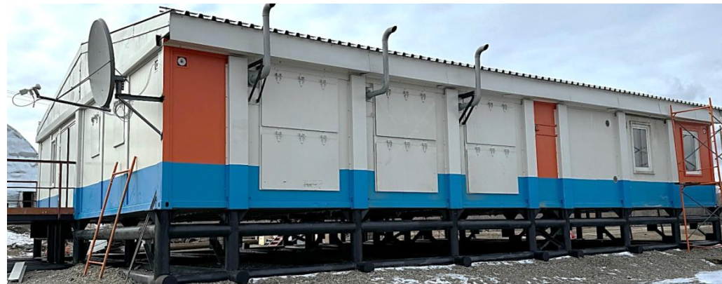
Энергоцентр - это «сердце» автономного гибридного энергокомплекса
