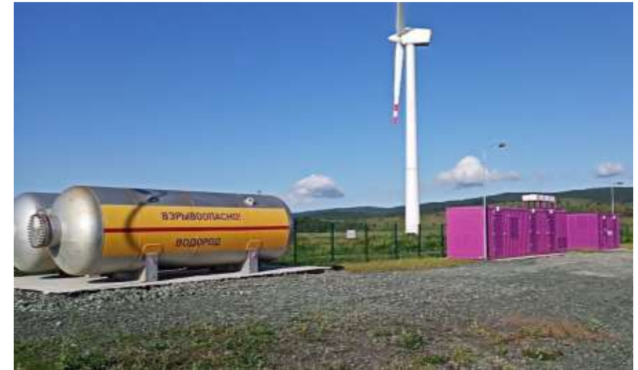
Оборудование водородного полигона на площадке АГЭК в с. Новиково
